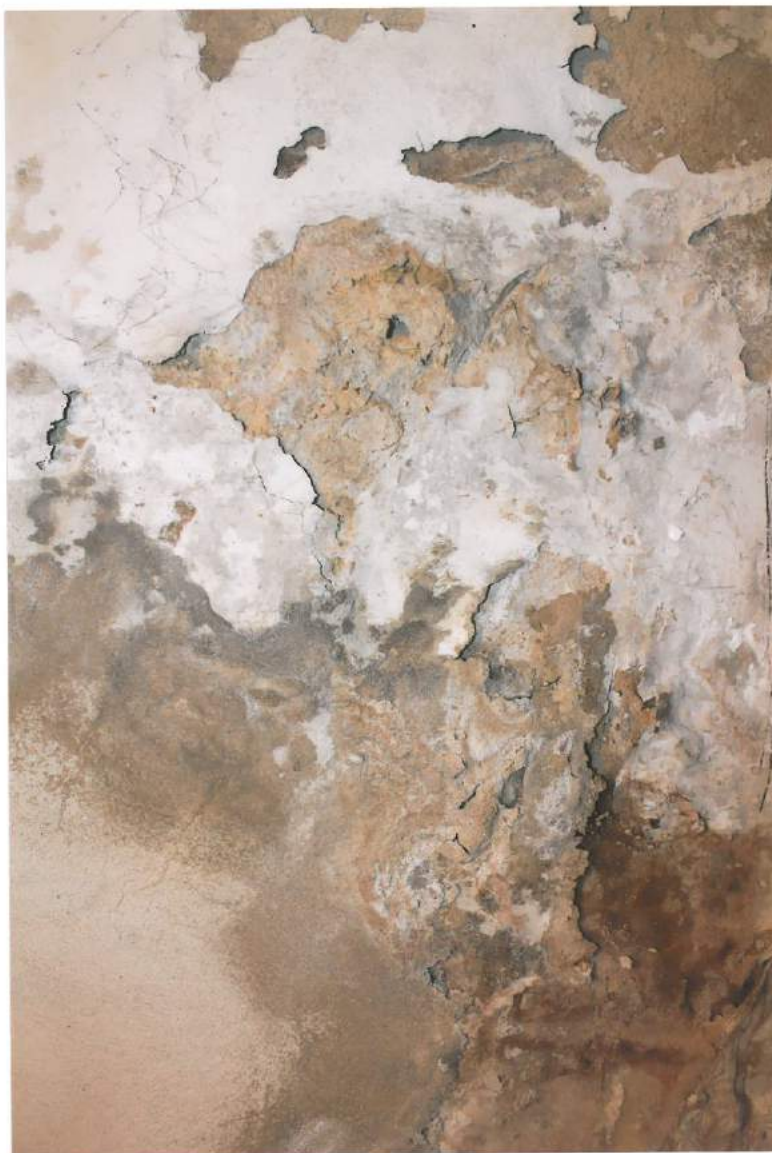
WILLA TEODORA SIXTA, BIELSKO-BIAŁA, 1883 R. Stan zachowania obiektu: piwnica, stan zawilgoconych murów z łuszczącymi się warstwami wypraw.
