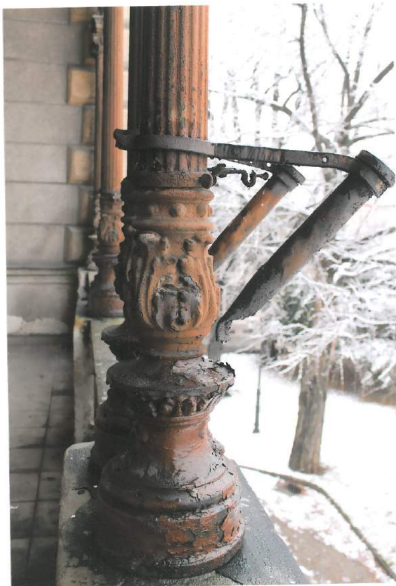
WILLA TEODORA SIXTA, BIELSKO-BIAŁA, 1883 R. Stan zachowania obiektu: elewacja wschodnia, piętro, loggia, baza kolumny, złuszczające się przemalowania, żeliwo.
