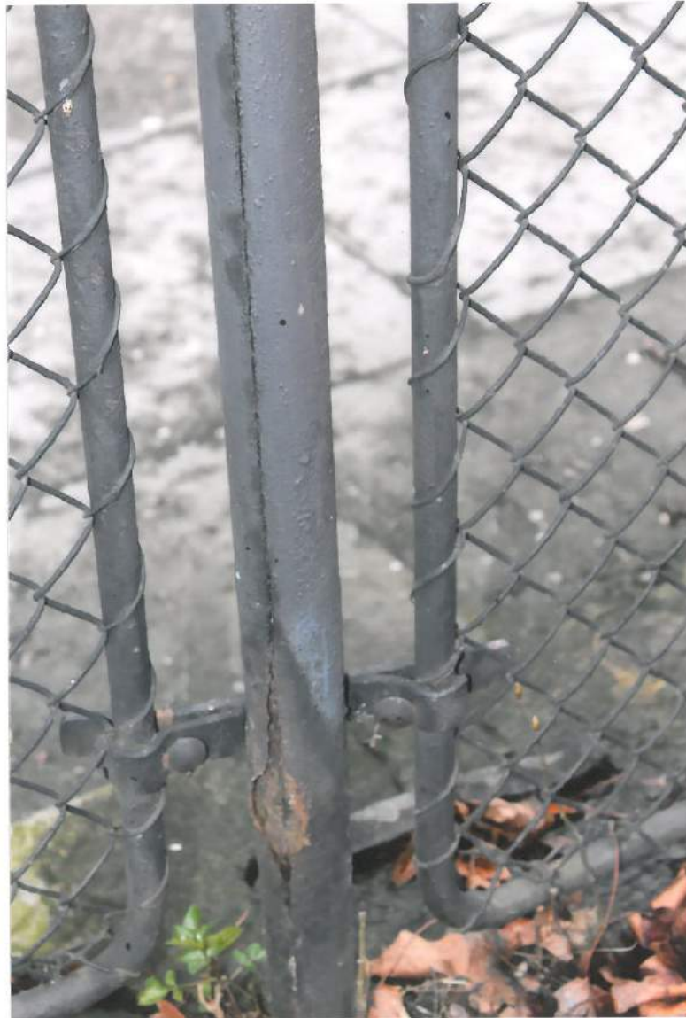
WILLA TEODORA SIXTA, BIELSKO-BIAŁA, 1883 R. Stan zachowania obiektu: ogrodzenie, zachód, wtórne, korodujące słupki i przęsła.
