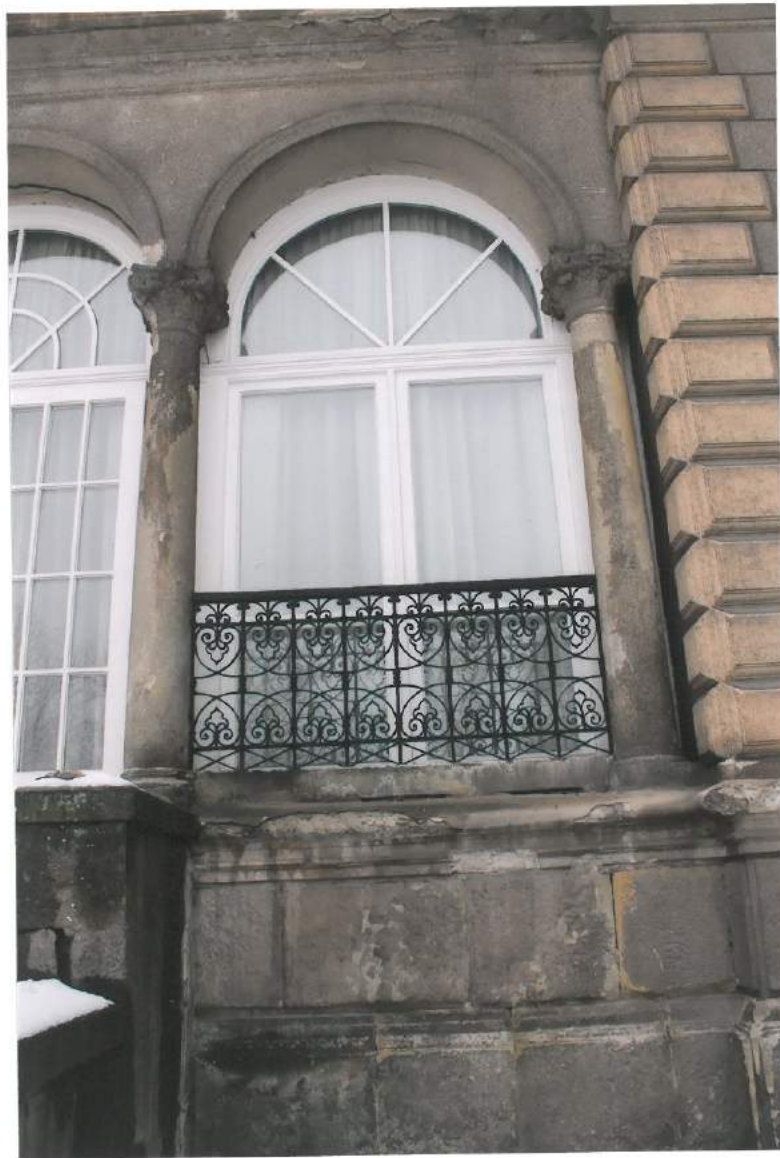
WILLA TEODORA SIXTA, BIELSKO-BIAŁA, 1883 R. Stan zachowania obiektu: elewacja wschodnia, arkada.
