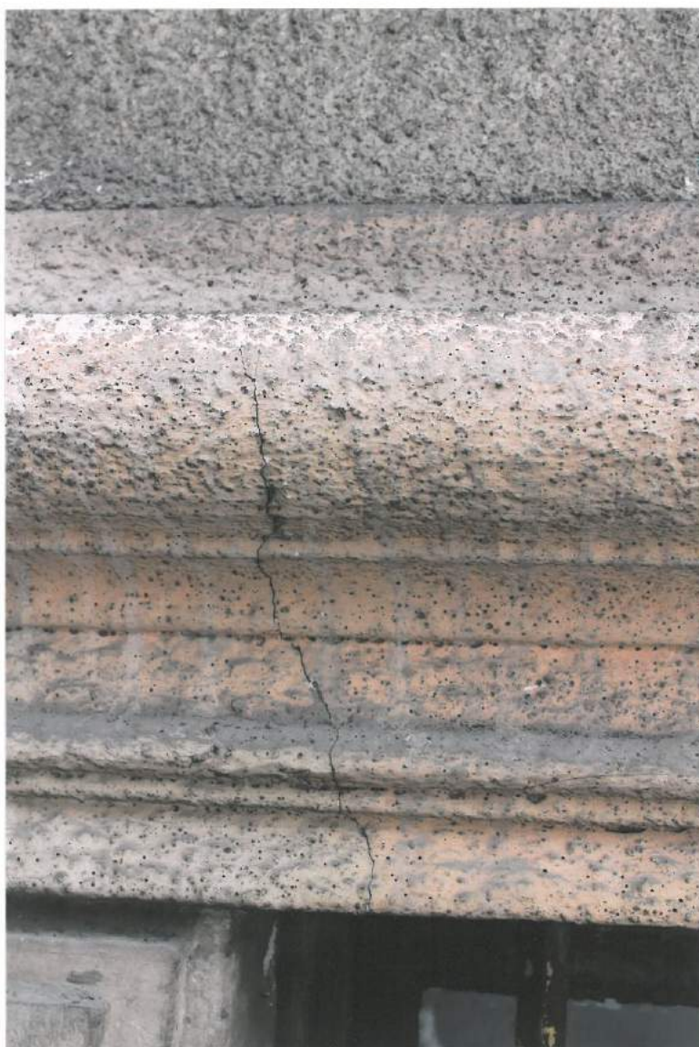
WILLA TEODORA SIXTA, BIELSKO-BIAŁA, 1883 R. Stan zachowania obiektu: elewacja południowa, okno w pasie cokołowym, fragm., pęknięcia gzymsu nadcokołowego.
