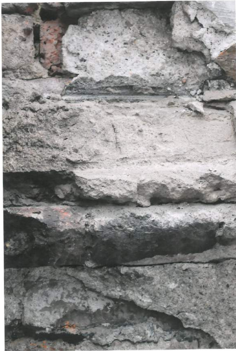
WILLA TEODORA SIXTA, BIELSKO-BIAŁA, 1883 R. Stan zachowania obiektu: elewacja północna, gzyms nadcokołowy, uszkodzenia powstałe w wyniku ingerencji wody w strukturę wypraw.
