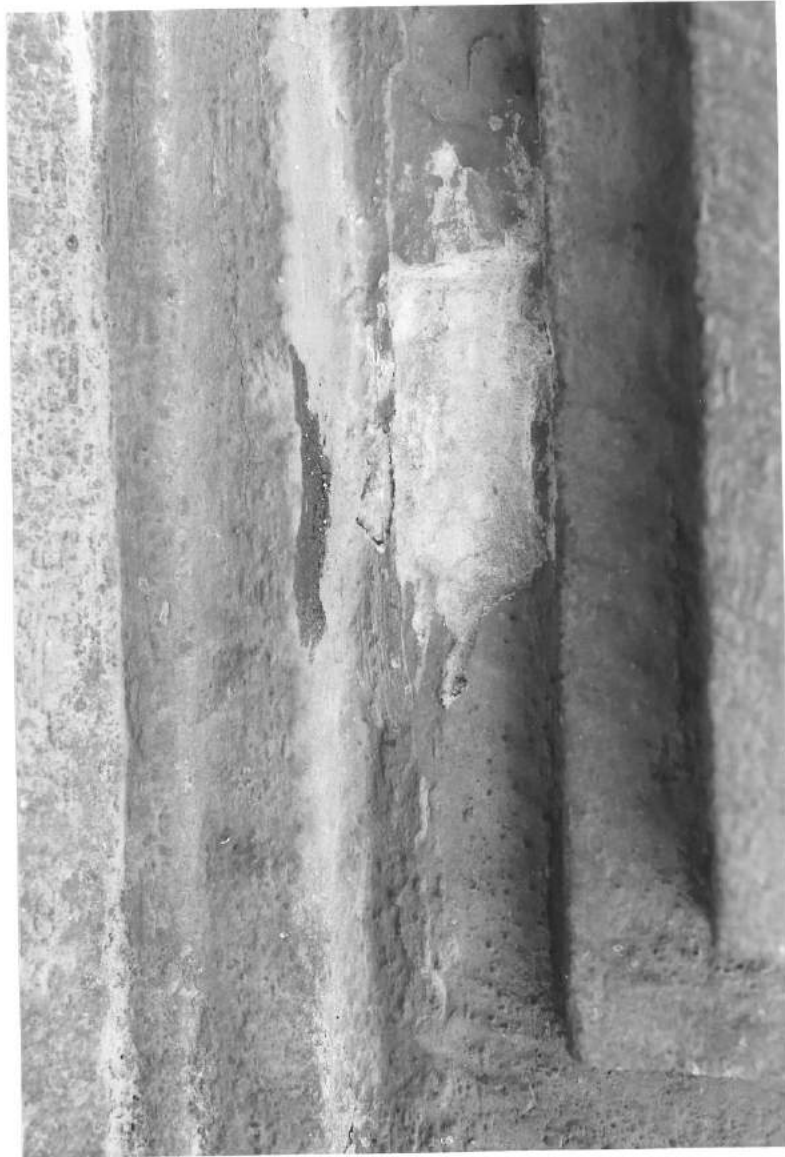
WILLA TEODORA SIXTA, BIELSKO-BIAŁA, 1883 R. Stan zachowania obiektu: elewacja południowa, cokół.
