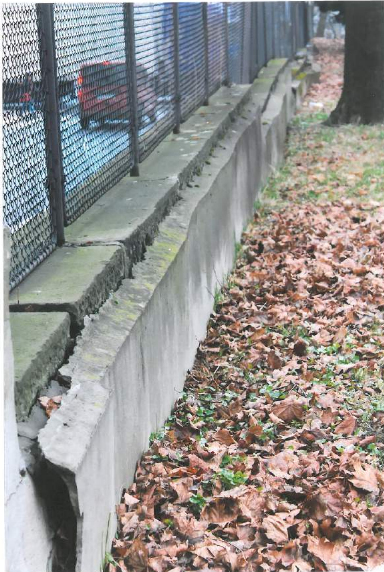
WILLA TEODORA SIXTA, BIELSKO-BIAŁA, 1883 R. Stan zachowania obiektu: ogrodzenie, północ, betonowa osłona muru kamiennego.
