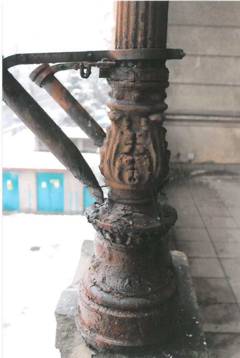
WILLA TEODORA SIXTA, BIELSKO-BIAŁA, 1883 R. Stan zachowania obiektu: elewacja wschodnia, piętro, loggia, baza kolumny, żeliwo.
