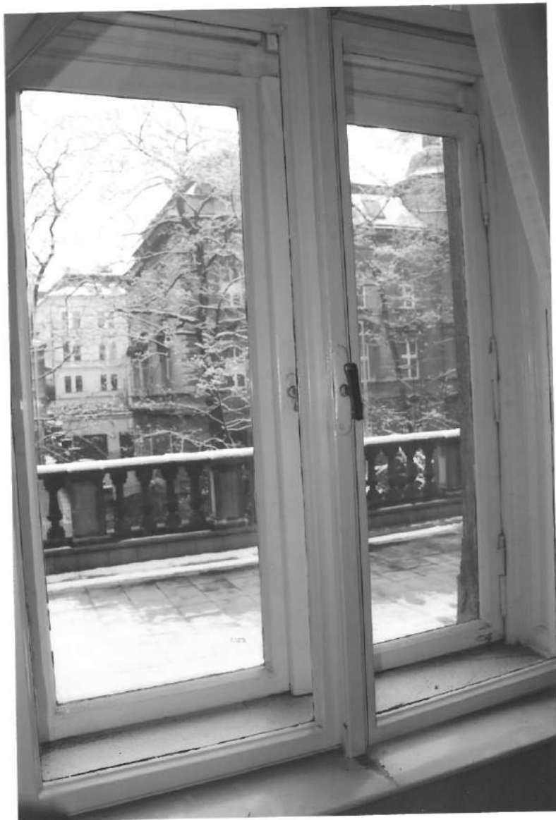
WILLA TEODORA SIXTA, BIELSKO-BIAŁA, 1883 R. Stan zachowania obiektu: elewacja zachodnia, piętro, okno skrzynkowe.
