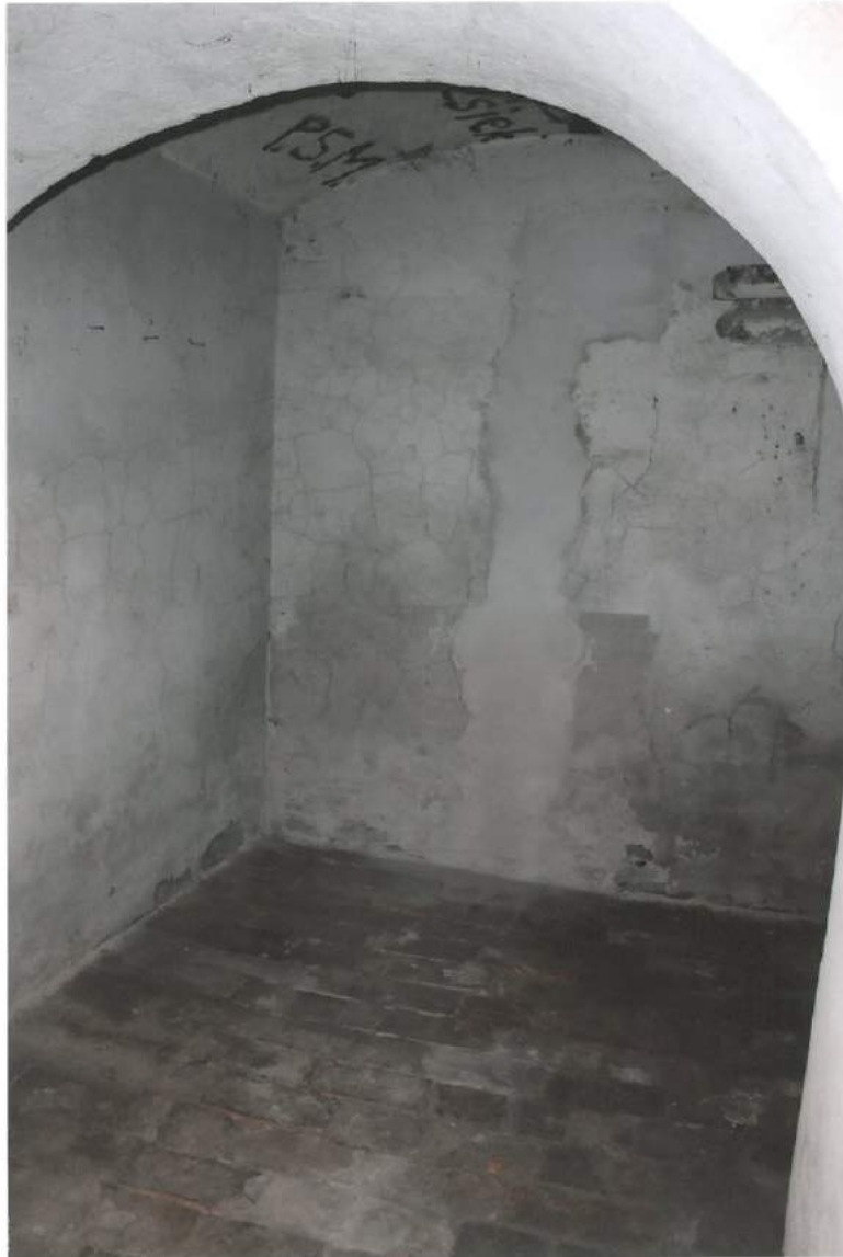
WILLA TEODORA SIXTA, BIELSKO-BIAŁA, 1883 R. Stan zachowania obiektu: piwnica.
